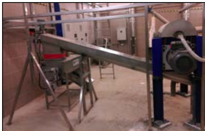
Budynek techniczny - higienizacja osadu
