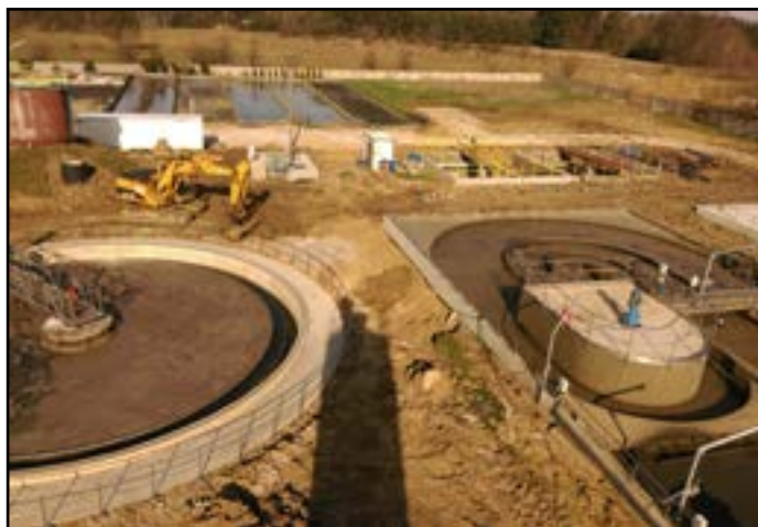
Bioreaktor po modernizacji
